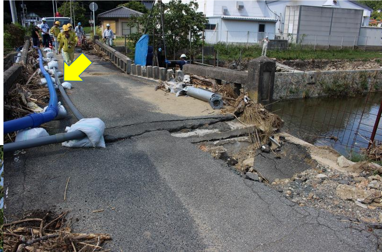
↑橋の破損と仮設水道管の設置
